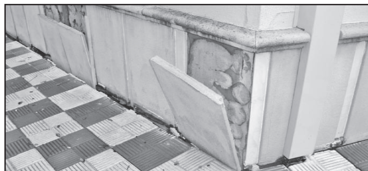
Grietas en La Peñalosa. La situación de las grietas y corrimientos es preocupante como apuntaba en el número anterior el alcalde pedáneo de La Peñalosa. Esperemos que no llegue todo demasiado lejos, y demasiado tarde las soluciones. En la foto se ve la inclinación del transformador y el estado de algunos Acerados separados de las viviendas.
